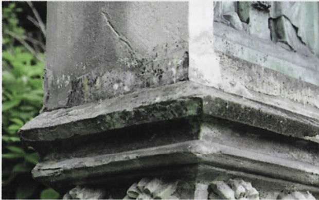
Schäden an den Sandstein-Stelen
